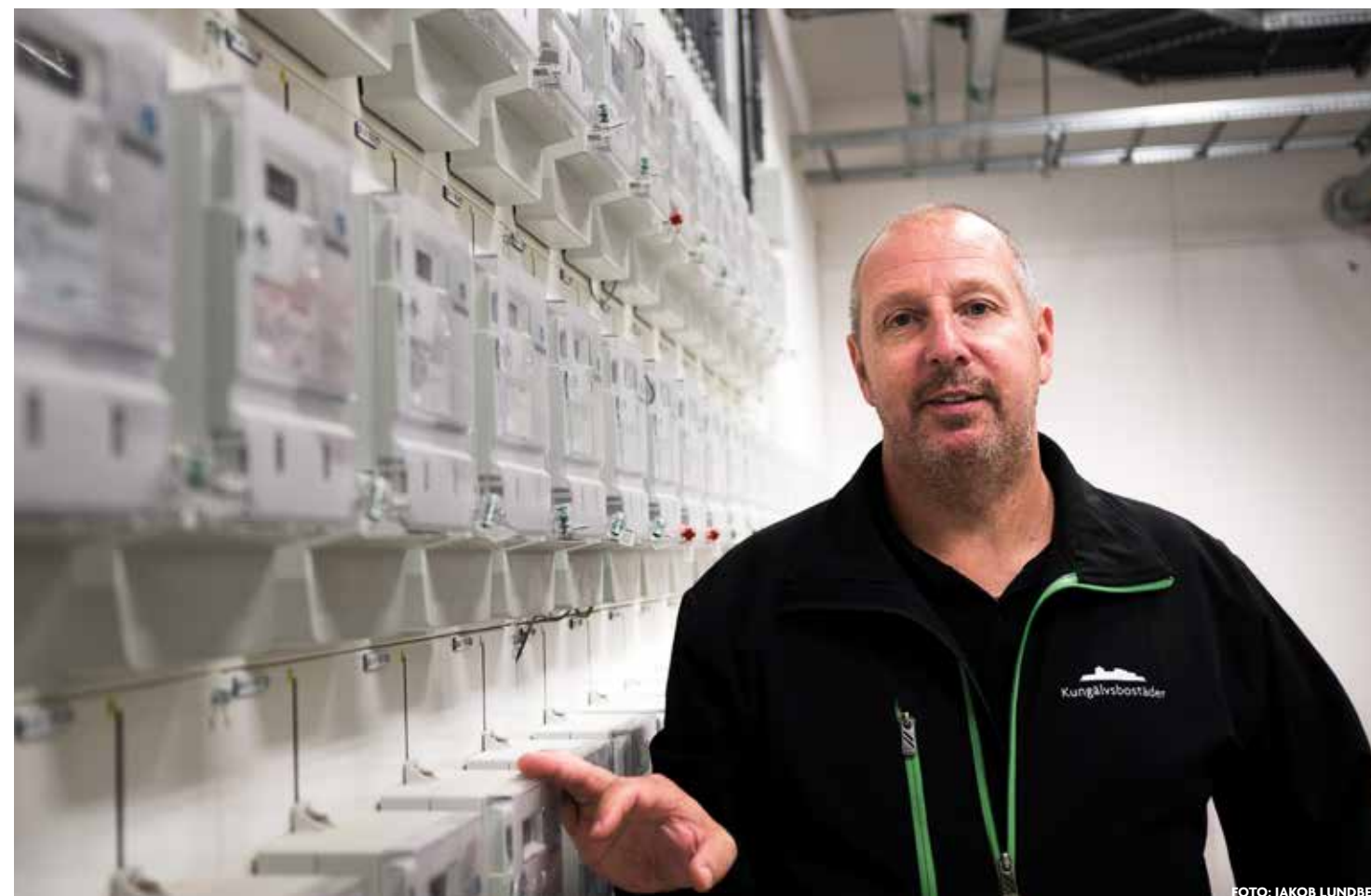
FOTO: JAKOB LUNDBERG Drifttekniker Nils Andersson kontrollerar regelbundet undercentralerna i källaren så att värme och pumpar fungerar som de ska.
